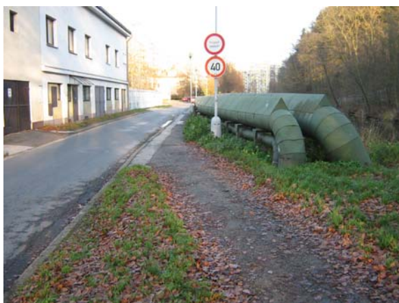
Obr. 3.2a: Současný stav vedení parovodního potrubí v ulici Mánesovo nábřeží
